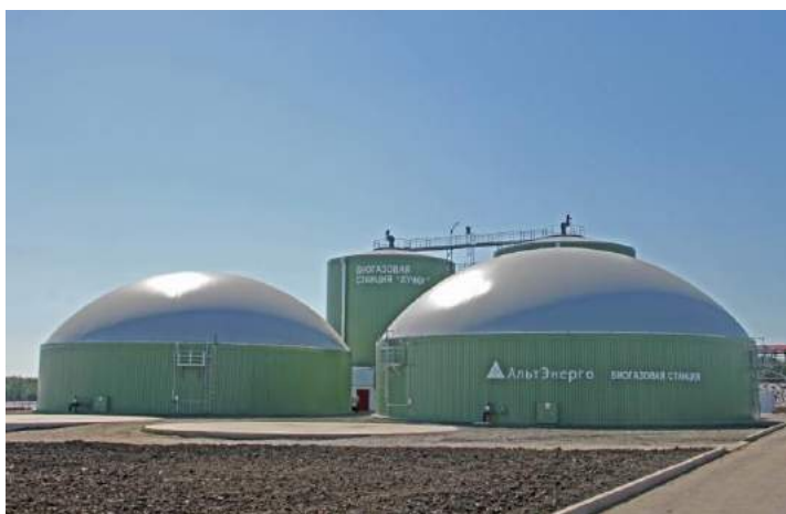
Рис. 4.14. Биогазовая станция «Лучки»
